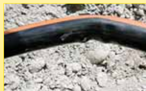
durch Bagger zerstört
