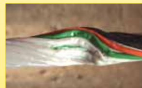
durch herunterfallende Schachtdeckel zerstört
